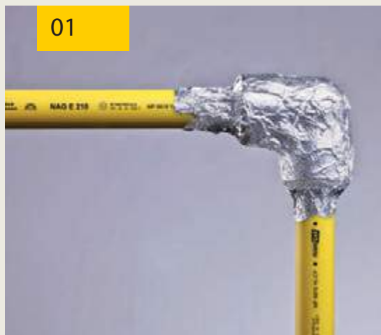
El primer paso para una protección efectiva es envolver todos los accesorios.
